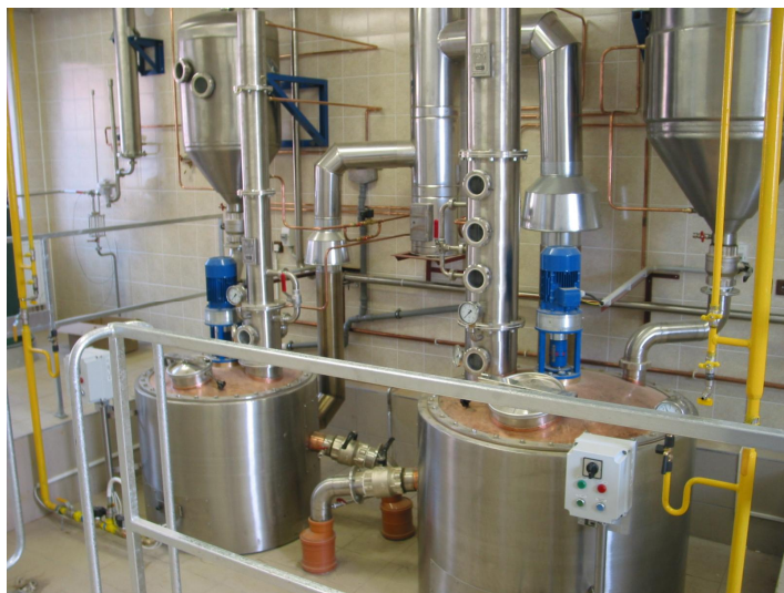
Plynofikace surovinového a rektifikačního kotle (DESTILA Brno)
